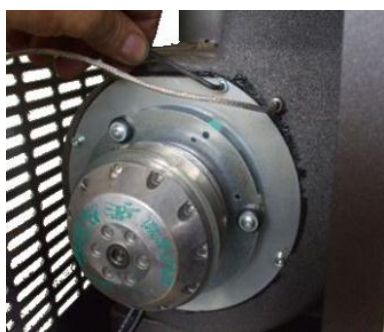
Fig. 40 - Pulizia aspiratore fumi: fase 1
