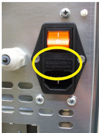
Fig. 48 - Trappe avec les fusibles à changer
