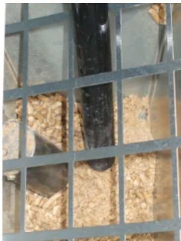
Fig. 45 - Reiniging van de voorraadbak en transportschroef
