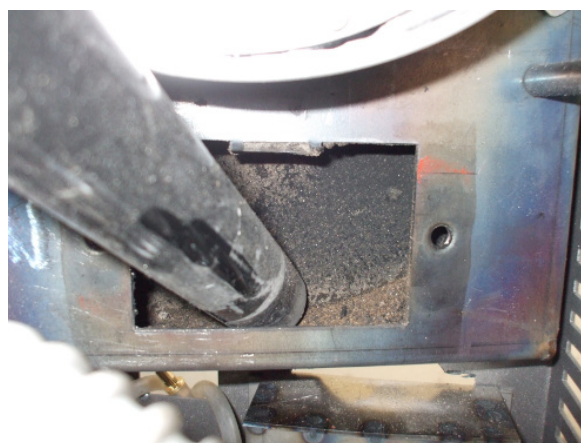
Fig. 47 - Limpieza cámara de humos
