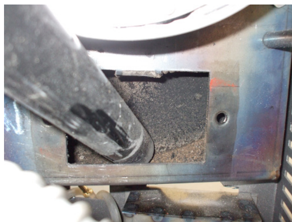
Fig. 47 - Pulizia camera fumi
